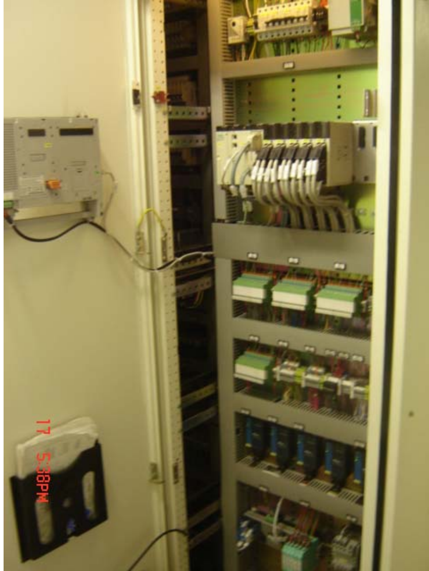
Şekil 2.5: PLCP1 Panosu İç Görünümü
