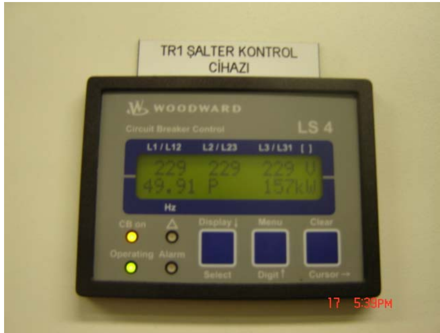
Şekil 3.9: LS4 Şalter Kontrol Rölesi
