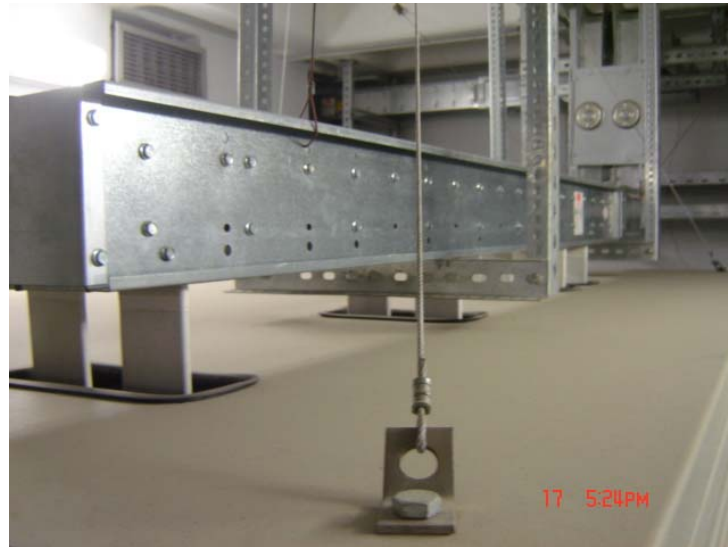
Şekil 3.14: Transformatör İkincil Sargı Çıkış Baraları Görünümü
