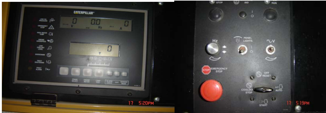
Şekil 3.16: Generatör Kontrol Panosu
